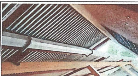
Foto 5: Sustrucción de canal de metal debido que esta en mal estado y hay partes que no tiene y el agua pública cae en los corredores.
