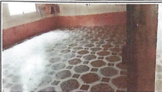
Foto 1: Sustrucción de piso cerámico debido a que se encuentra en mal estado.
